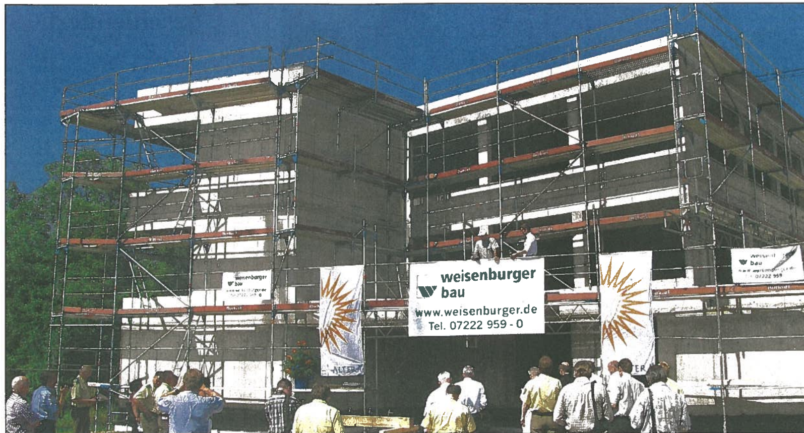
RICHTFEST: Planmäßig laufen die Arbeiten an dem Gebäude im Bietigheimer Gebiet „Langgewann“, in das Ende des Jahres der drittgrößte Polizeiposten im Bereich der Polizeidirektion Rastatt/Baden-Baden einziehen wird. In dem Haus soll auch ein ambulanter Pflegedienst untergebracht werden. Foto: ler
